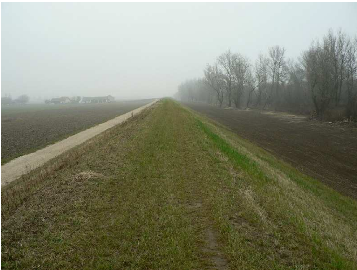
Fot. 8 Korpus wału z drogą przywałową oraz widoczną odbudową międzywała przy stopie wału. – Tarnowce – Słupiec.
