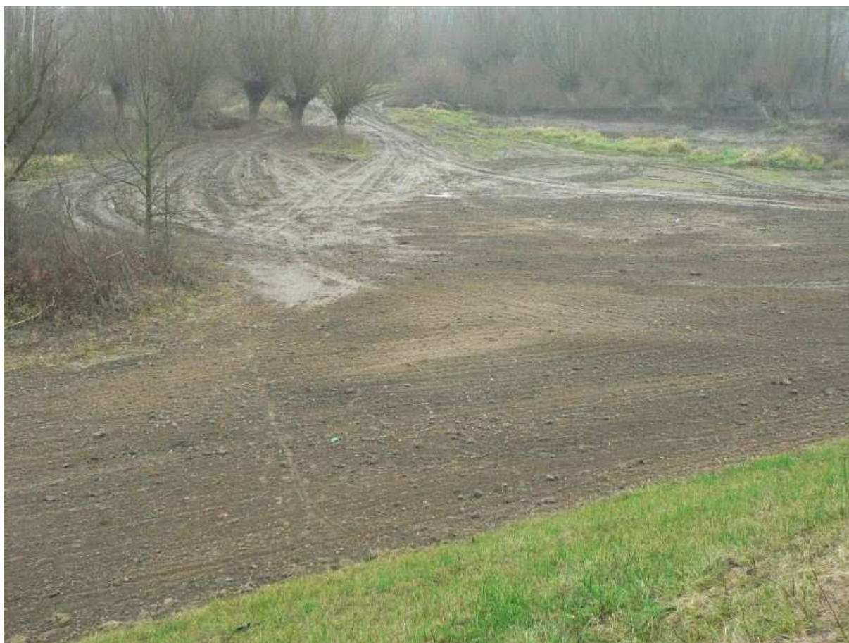
Fot. 4 Skarpa odwodna wału z widocznym fragmentem odbudowy zniszczonej w czasie powodzi skarpy i międzywała przy stopie – Tarnowce – Słupiec.
