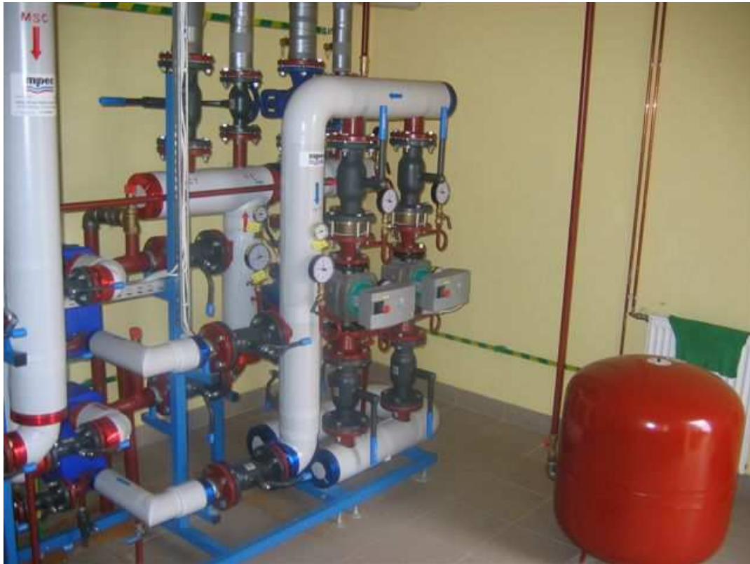
Fot. 60 Wymiennikownia ciepła.
