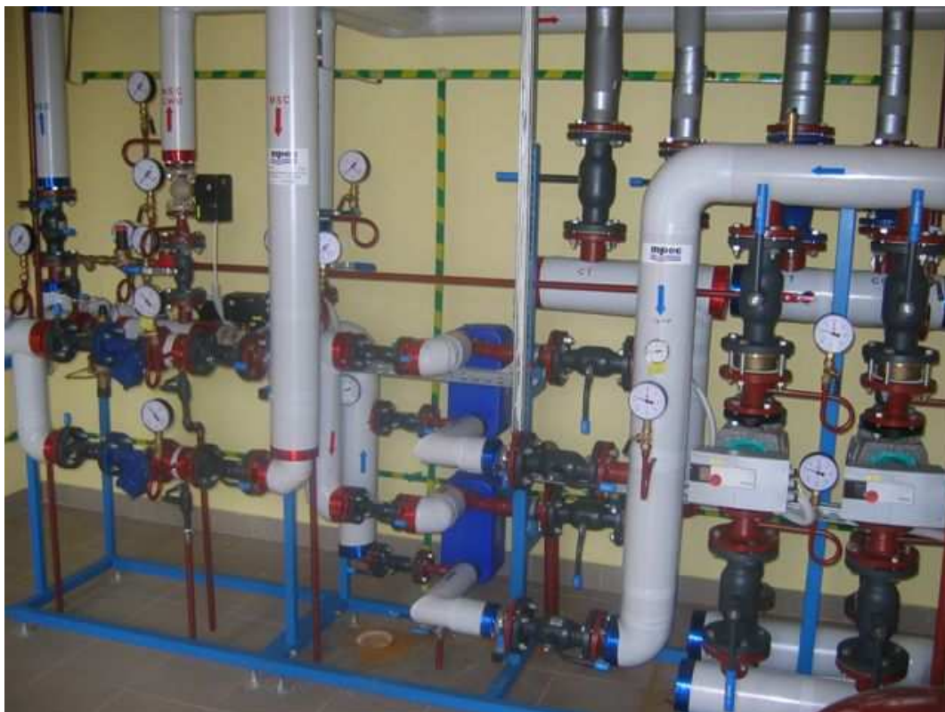
Fot. 57 Wymiennikownia ciepła.
