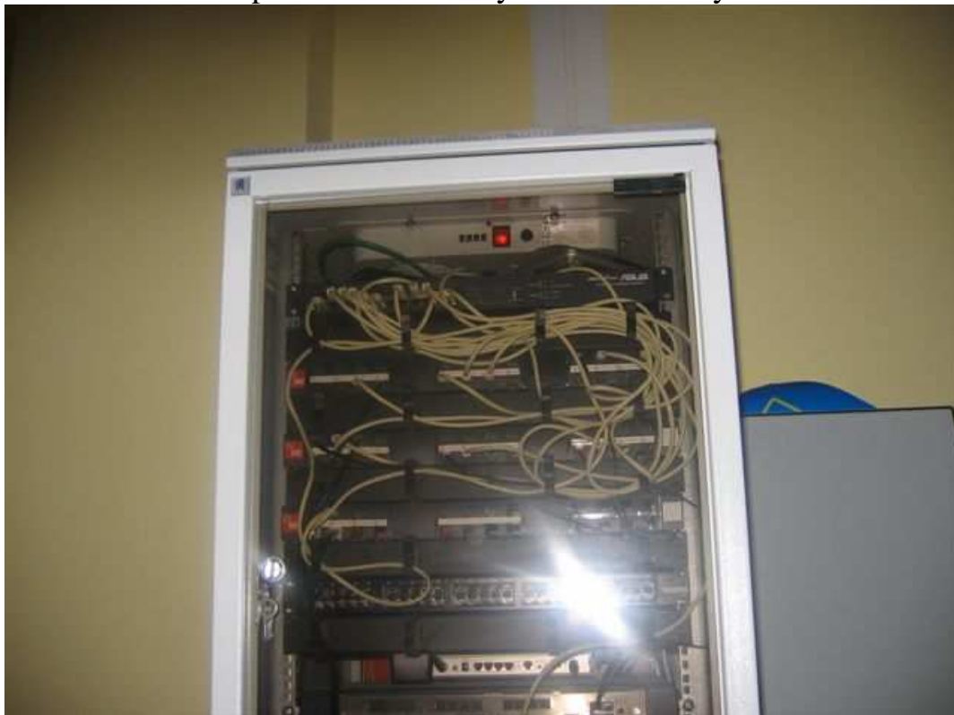
Fot.15 Szafa sterownicza w serwerowni.
