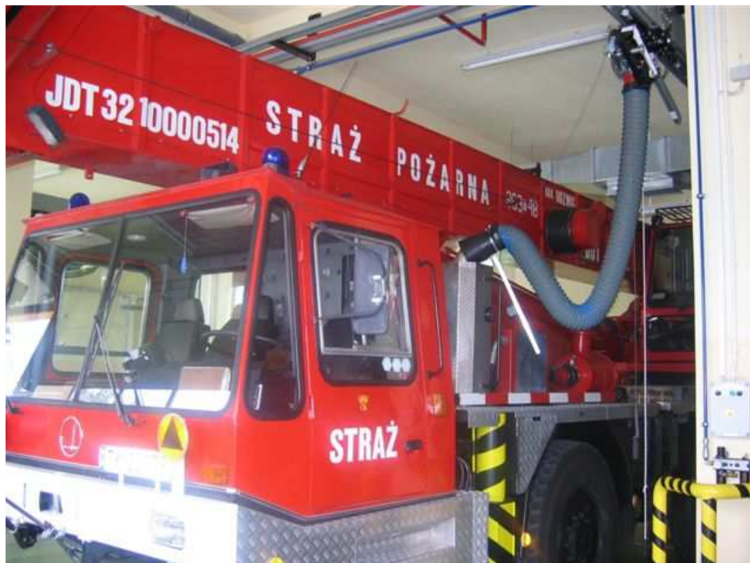
Fot.68 Instalacja odciagu spalin.
