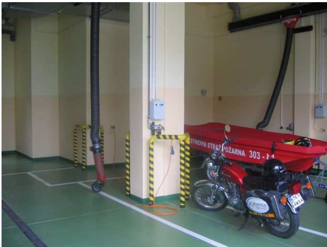
Fot. 45 Instalacja odciągu spalin dla pojazdów mechanicznych.
