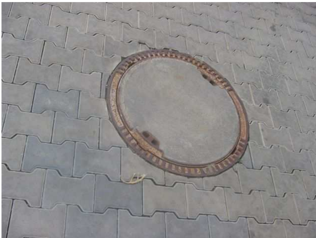
Fot. 48 Studzienka z Separatorem olejowym
