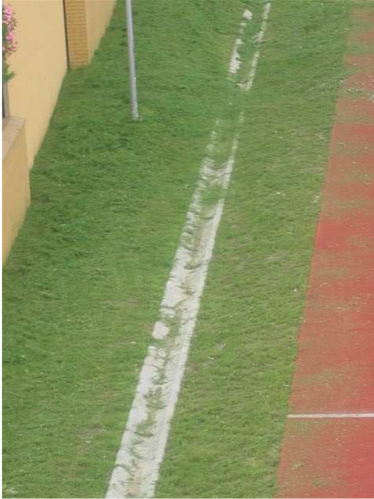
Fot.38 Odwodnienie terenu zewnętrznego.
