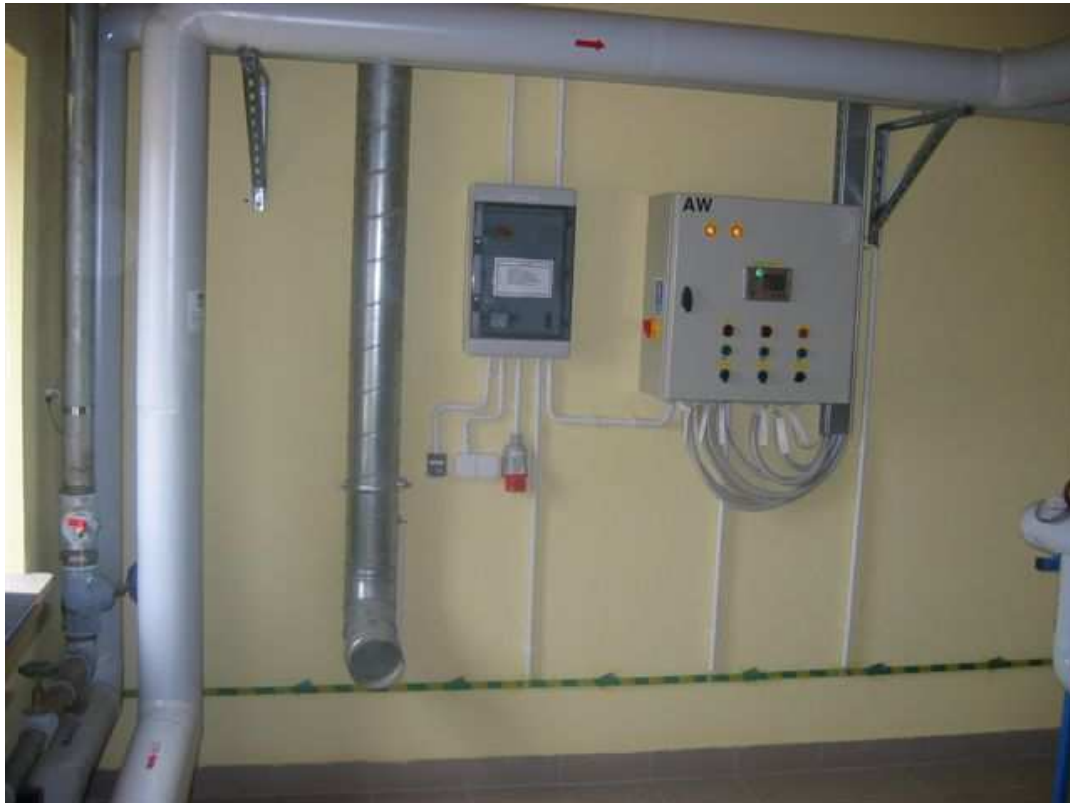
Fot. 58 Wymiennikownia - sterownik węzła cieplnego.
