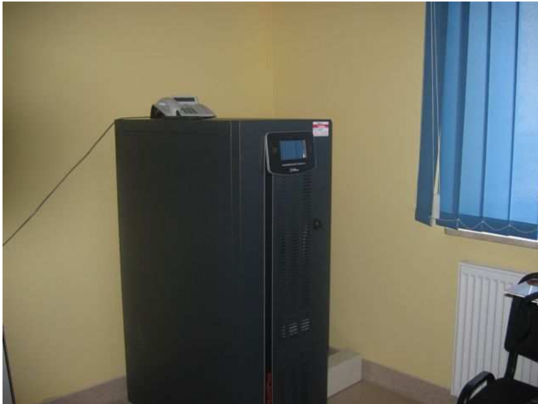
Fot. 14 Switch do przetwarzania danych teleadresowych w serwerowni.
