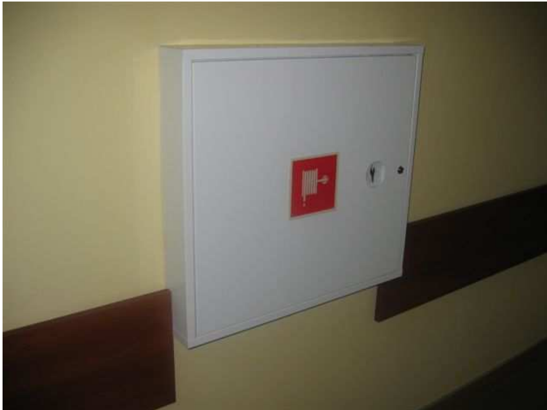
Fot.22 Szafka hydrantowa W-52.
