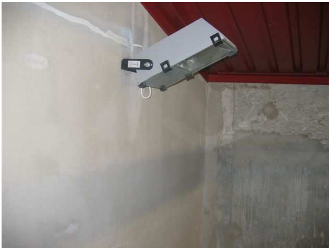
Fot.36 Wieża ćwiczeń specjalistycznych – oświetlenie.
