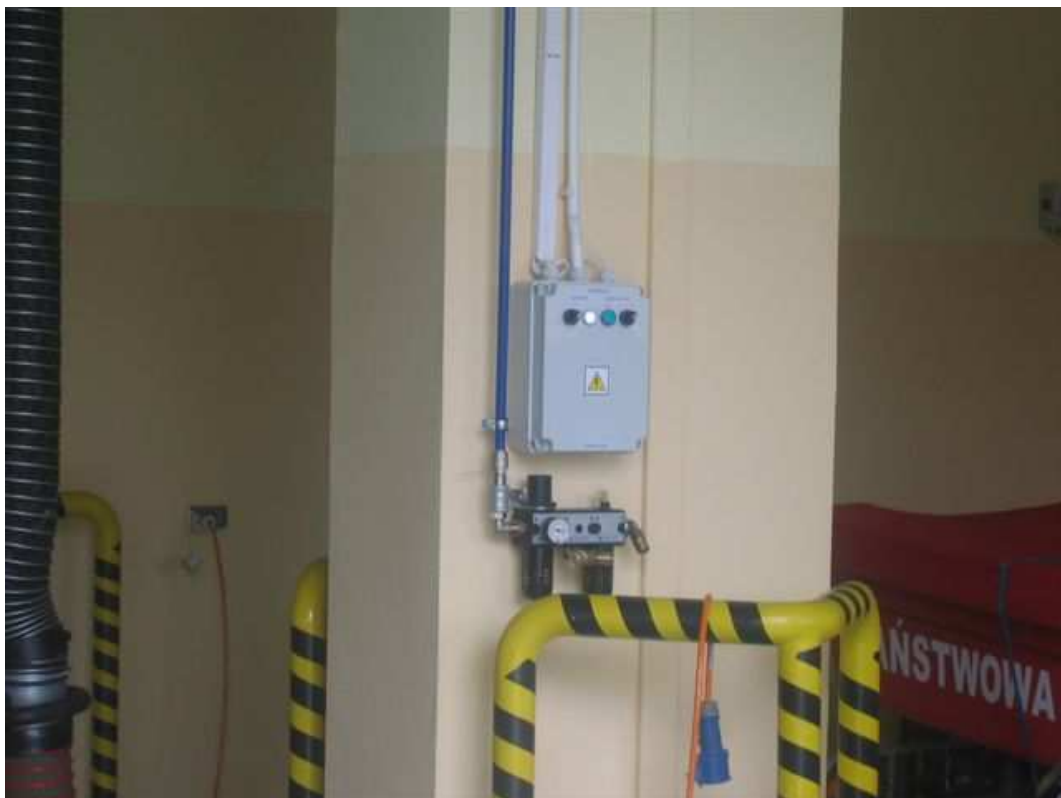
Fot.46 Sterownik odciągu spalin i zasilanie układu pneumatycznego dla pojazdu.
