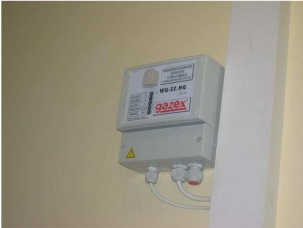
Fot. 28 Detektor tlenku węgla w pomieszczeniu.
