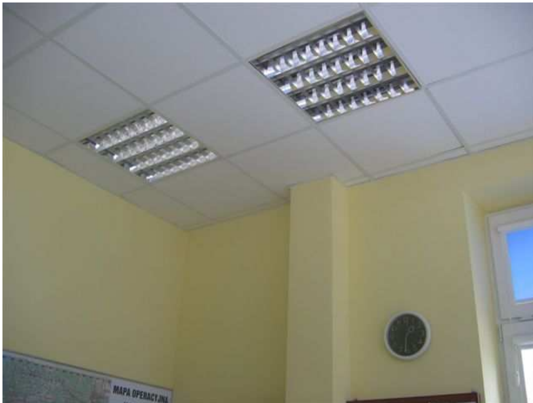
Fot. 12 Oświetlenie punktu alarmowego.
