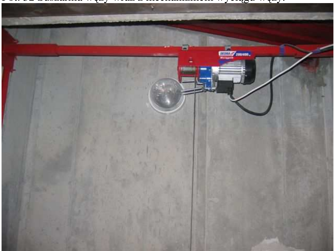
Fot. 33 Mechanizm wyciągu węży.
