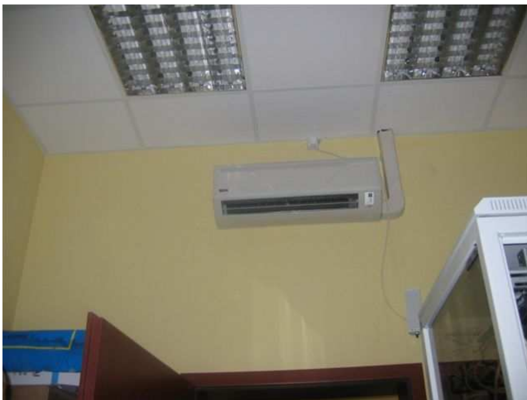
Fot.13 Serwerownia z klimatyzacją
