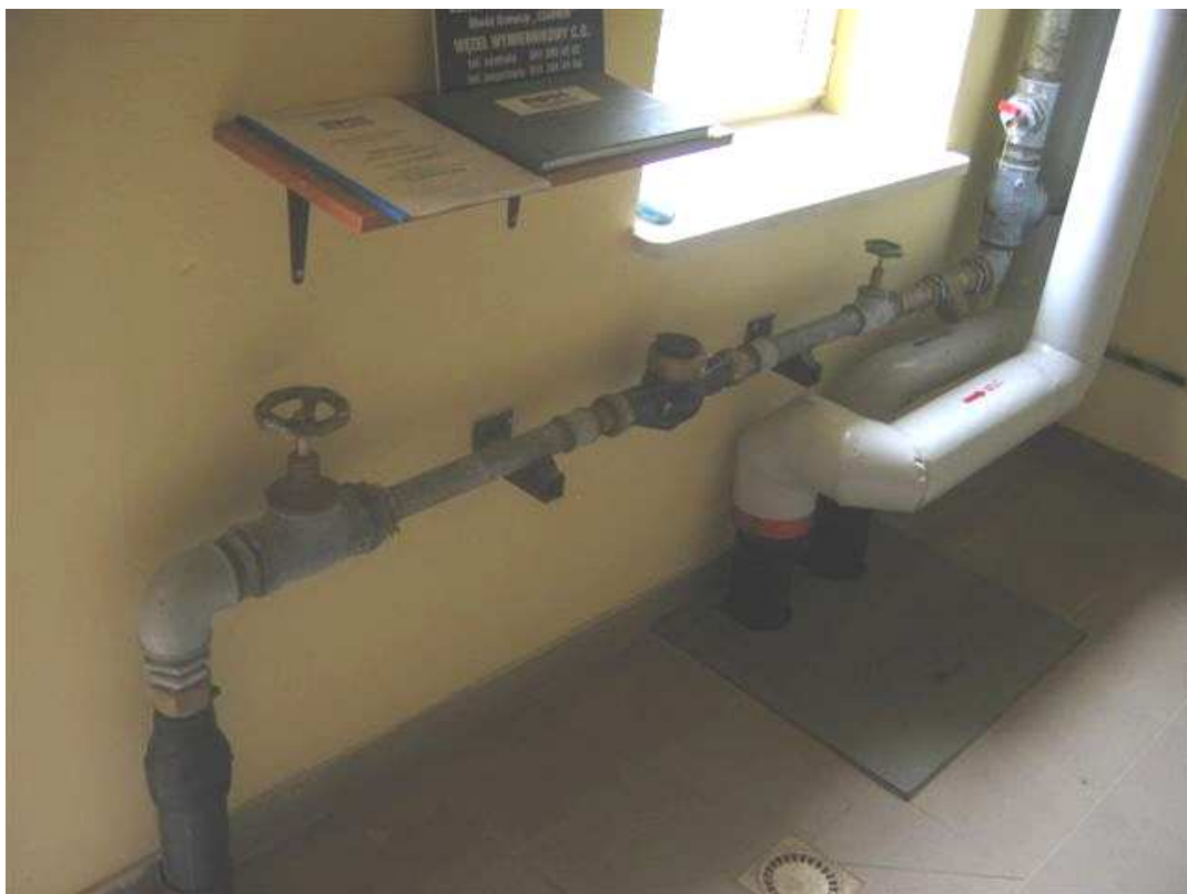
Fot. 59 Wymiennikownia – przyłącze wodociągowe.
