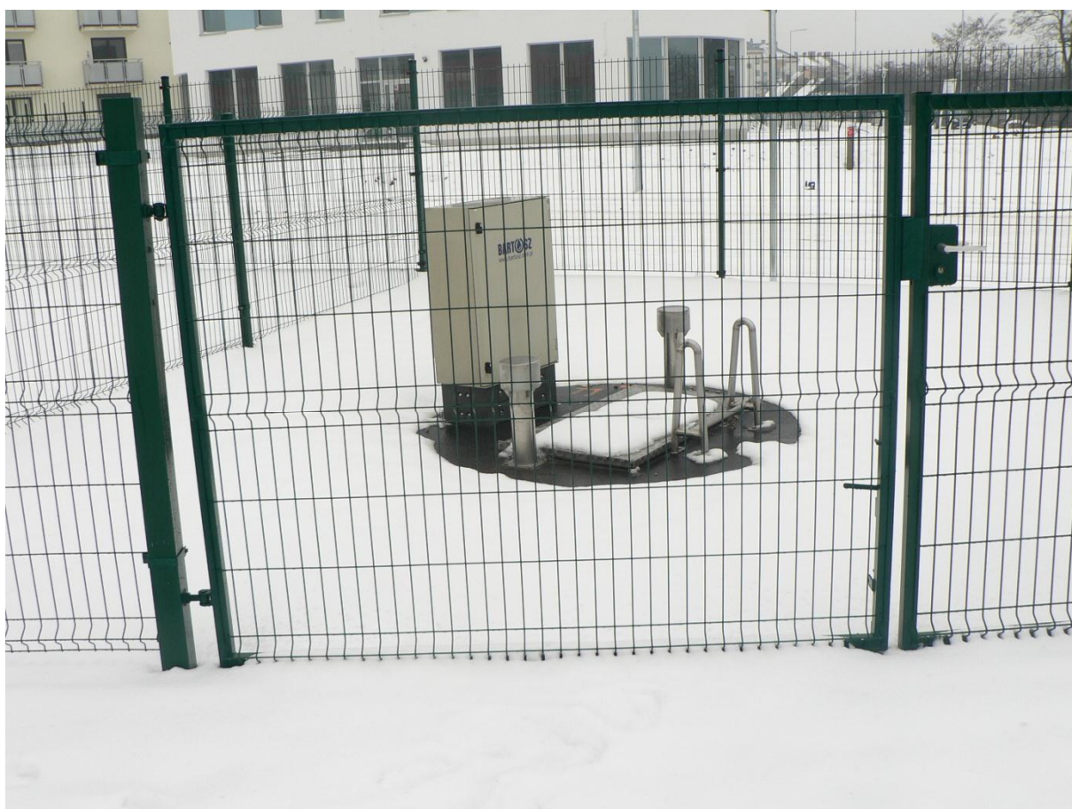
Przepompownia przy Osiedlu nr 17 - Kielce
