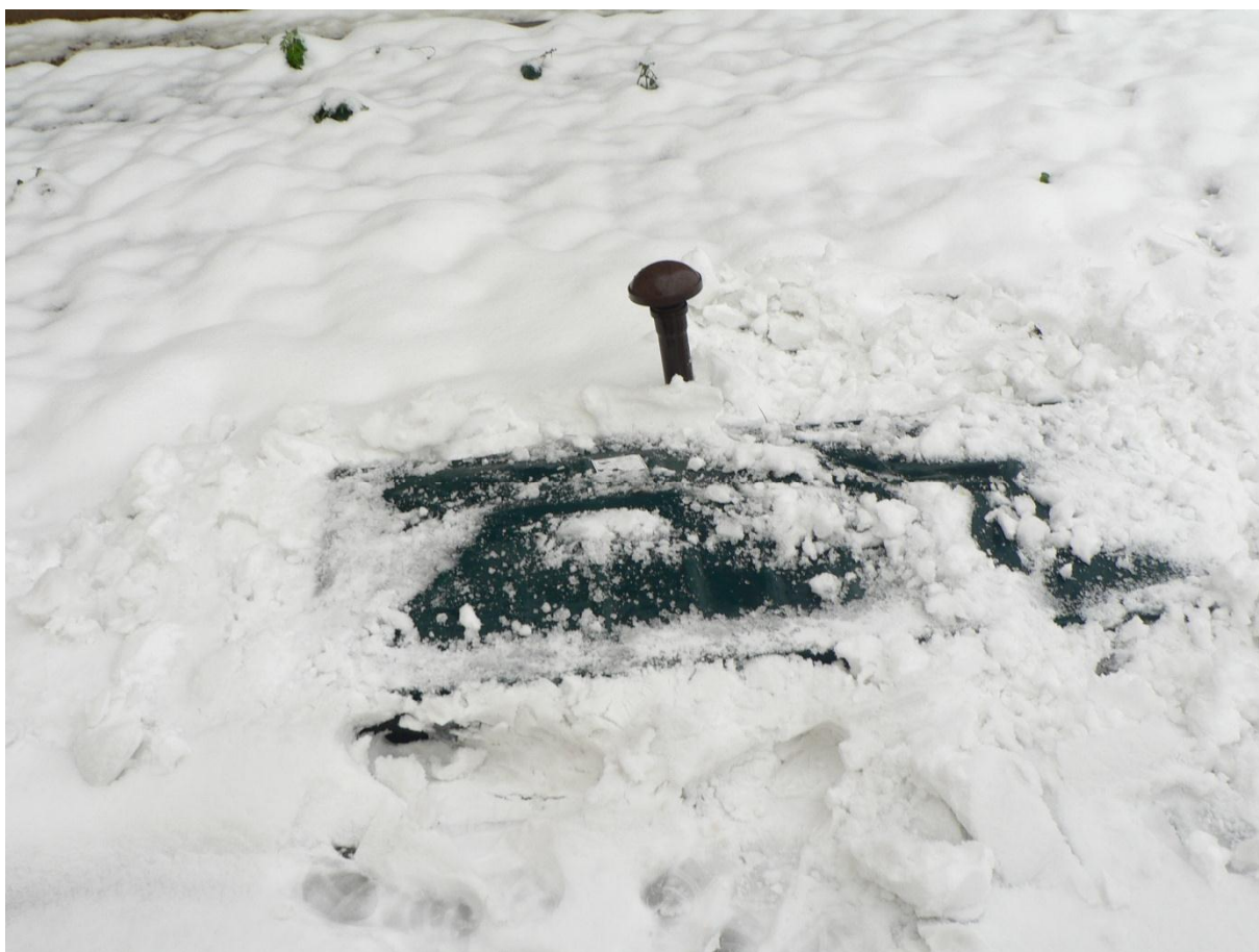
Separator tłuszczu w Obku nr 17 - Kielce
