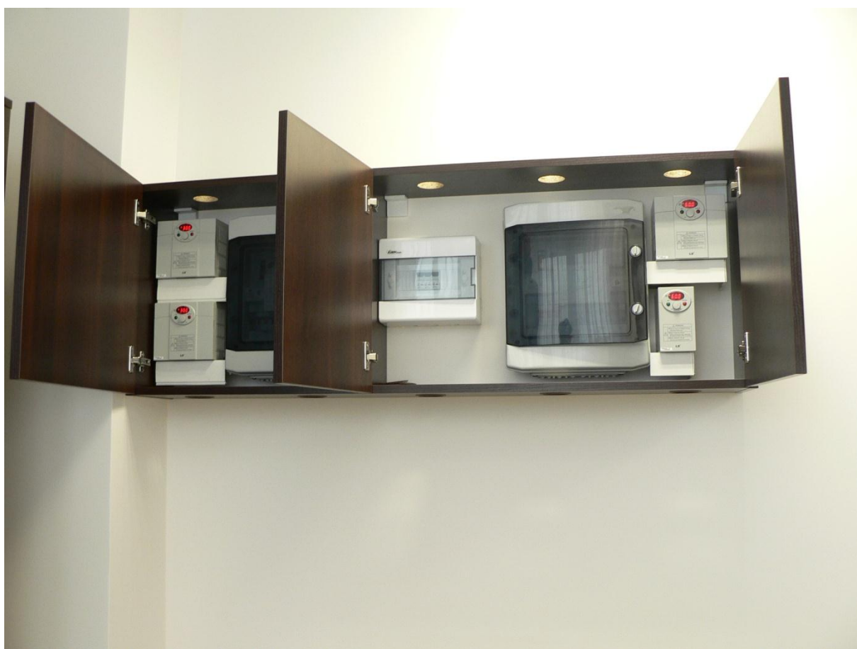
Instalacja wentylacyjna w Łbku nr 17 - Kielce
