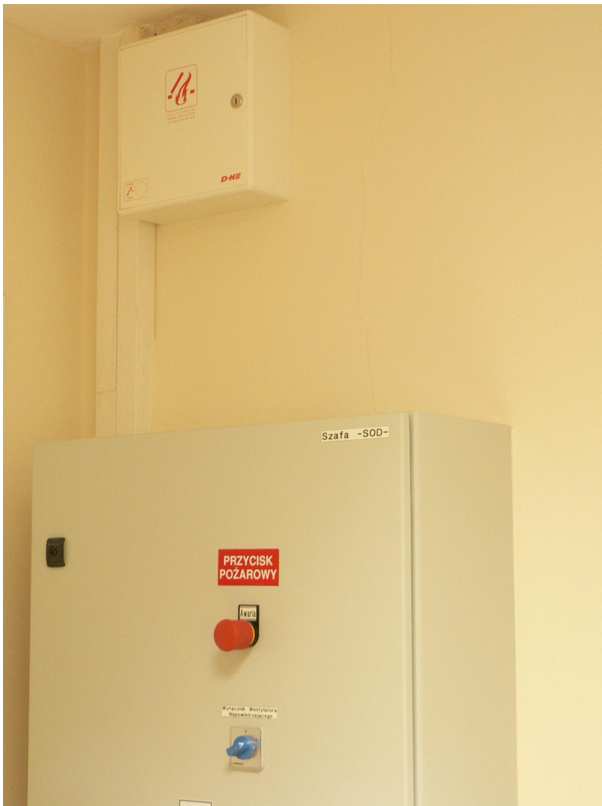
Instalacja przeciwpożarowa w bloku nr 17 - Kielce
