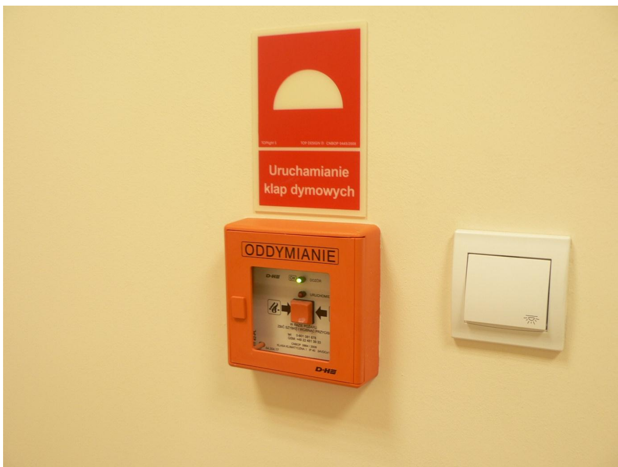
Instalacja oddymiania w Ćbku nr 17 - Kielce
