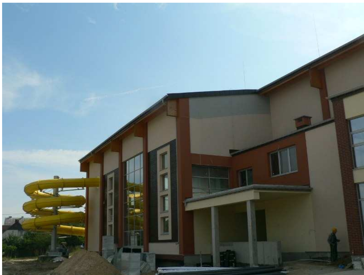
Zdj.13 Hala basenowa z widoczną rurą „zjeżdżalnią” .
