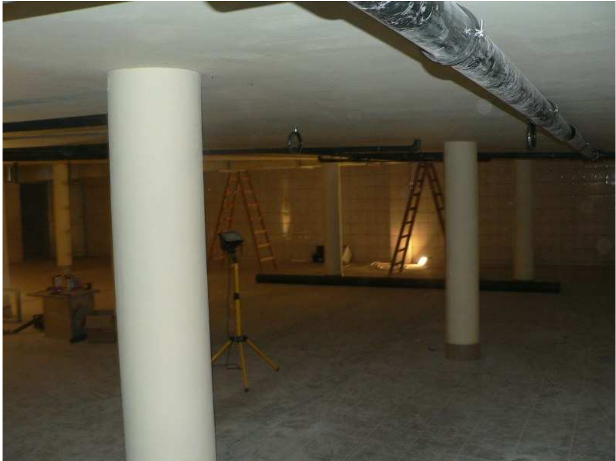
Zdj. 12 Rury doprowadzające wodę do basenu ( pomieszczenie pod basenem – niska kondygnacja), przystosowane do zainstalowania aparatury „basenowej”.
