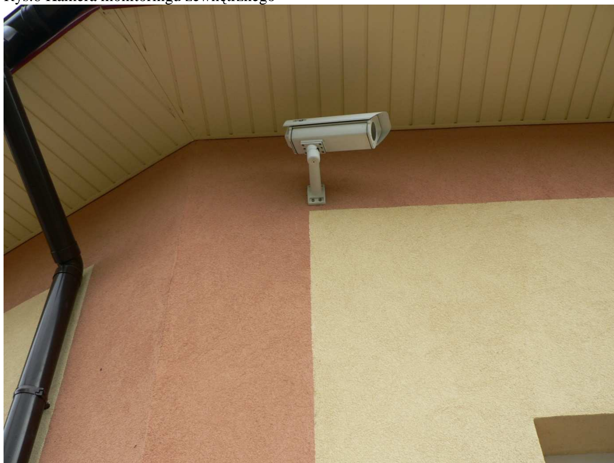
Rys.6 Kamera monitoringu zewnętrznego
