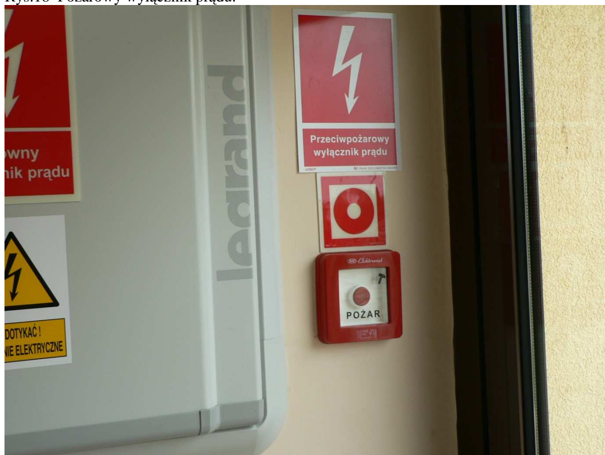
Rys.18 Pożarowy wyłącznik prądu.
