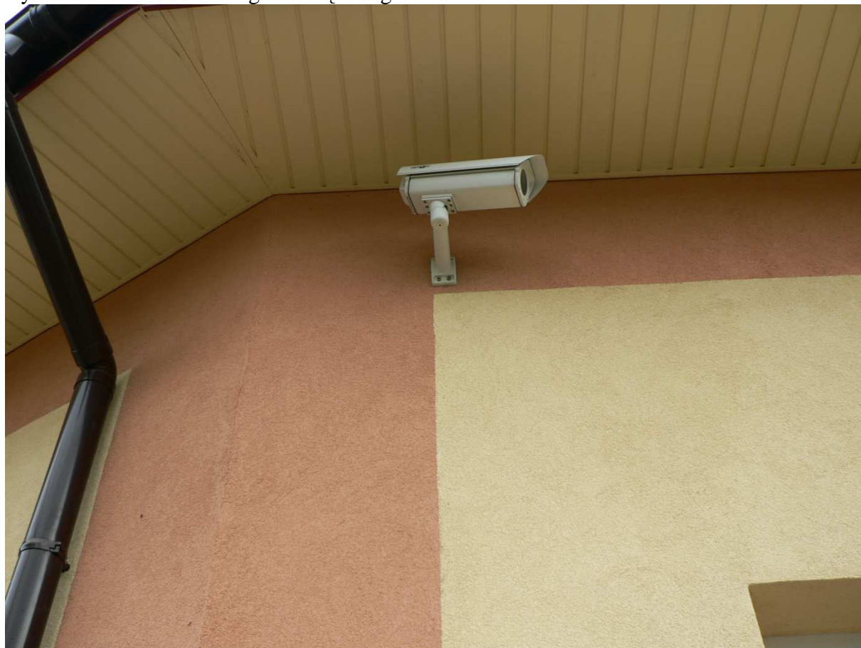
Rys.31 Kamera monitoringu zewnętrznego
