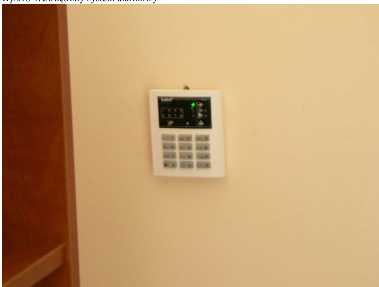
Rys.10 Wewnętrzny system alarmowy
