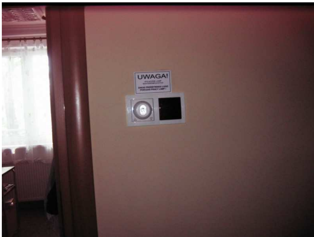
Fot.26. Budynek mieszkalny oddziału dorosłych w Domu Pomocy Społecznej w Mnichowie – instalacja lamp bakteriobójczych
