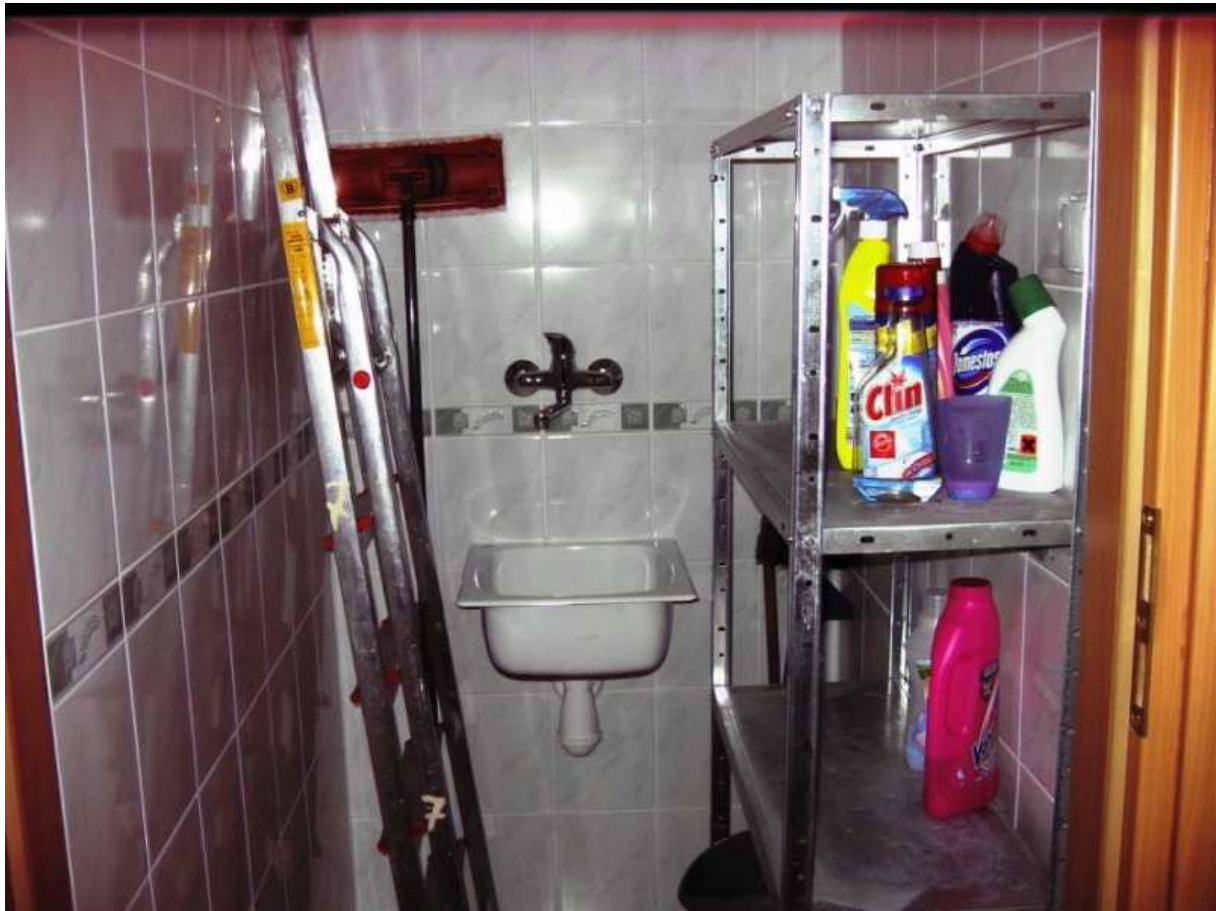
Fot.26. Budynek mieszkalny oddziału dorosłych w Domu Pomocy Społecznej w Mnichowie – pomieszczenie porządkowe
