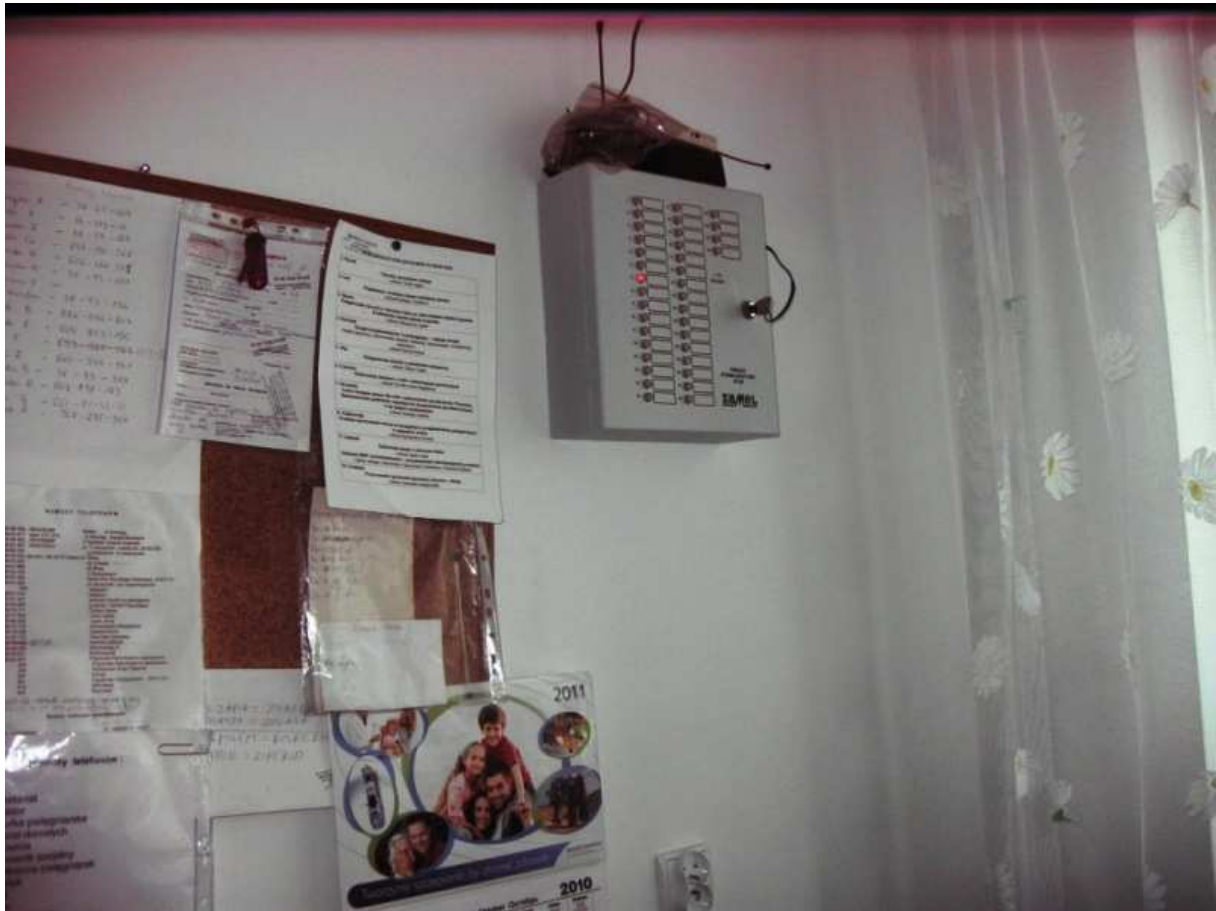
Fot.25. Budynek mieszkalny oddziału dorosłych w Domu Pomocy Społecznej w Mnichowie – wewnętrzna sygnalizacja przyzywowa
