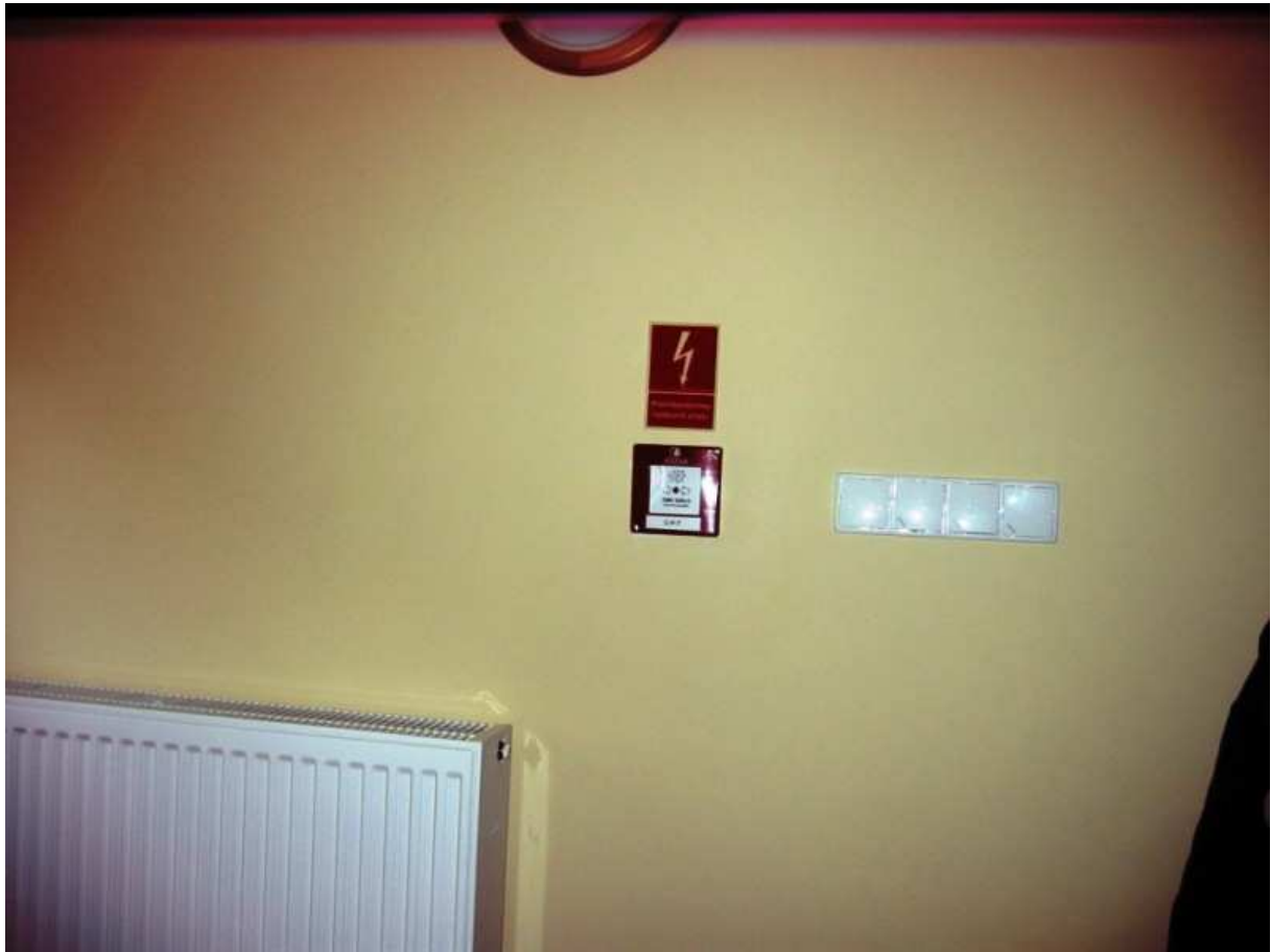
Fot.29. Budynek mieszkalny oddziału dorosłych w Domu Pomocy Społecznej w Mnichowie wyłącznik prądu
