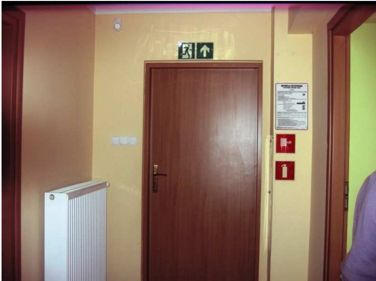
Fot. 30. Budynek mieszkalny oddziału dorosłych w Domu Pomocy Społecznej w Mnichowie - gaśnica, hydrant ,wyjście ewakuacyjne
