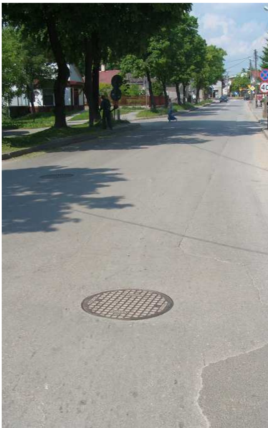
Fot. 11 Kanalizacja deszczowa na ul. Kościuszki w Busku - Zdroju
