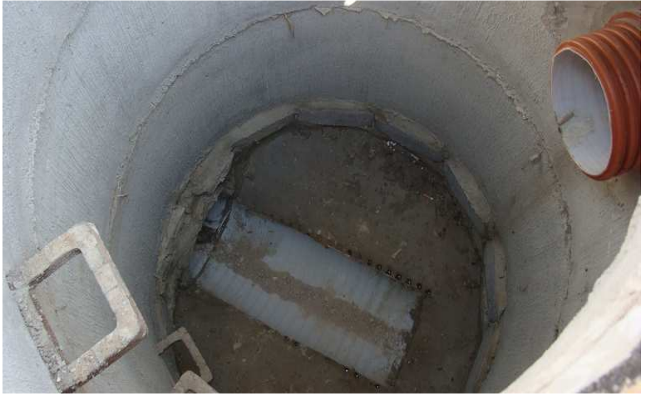
Fot. 18 Studnia rewizyjna na ul. Kilińskiego w Busku - Zdroju
