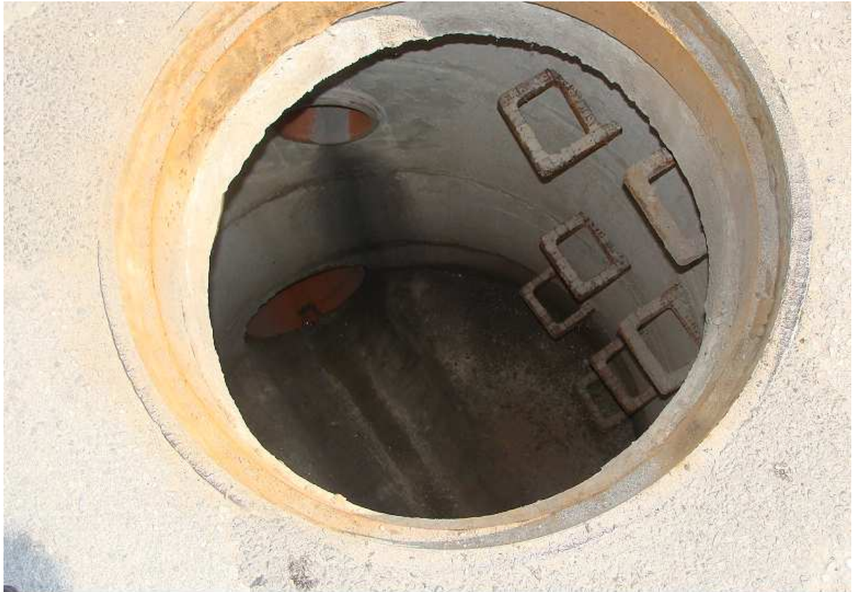
Fot. 5 Studnia rewizyjna na ul. Kopernika w Busku - Zdroju
