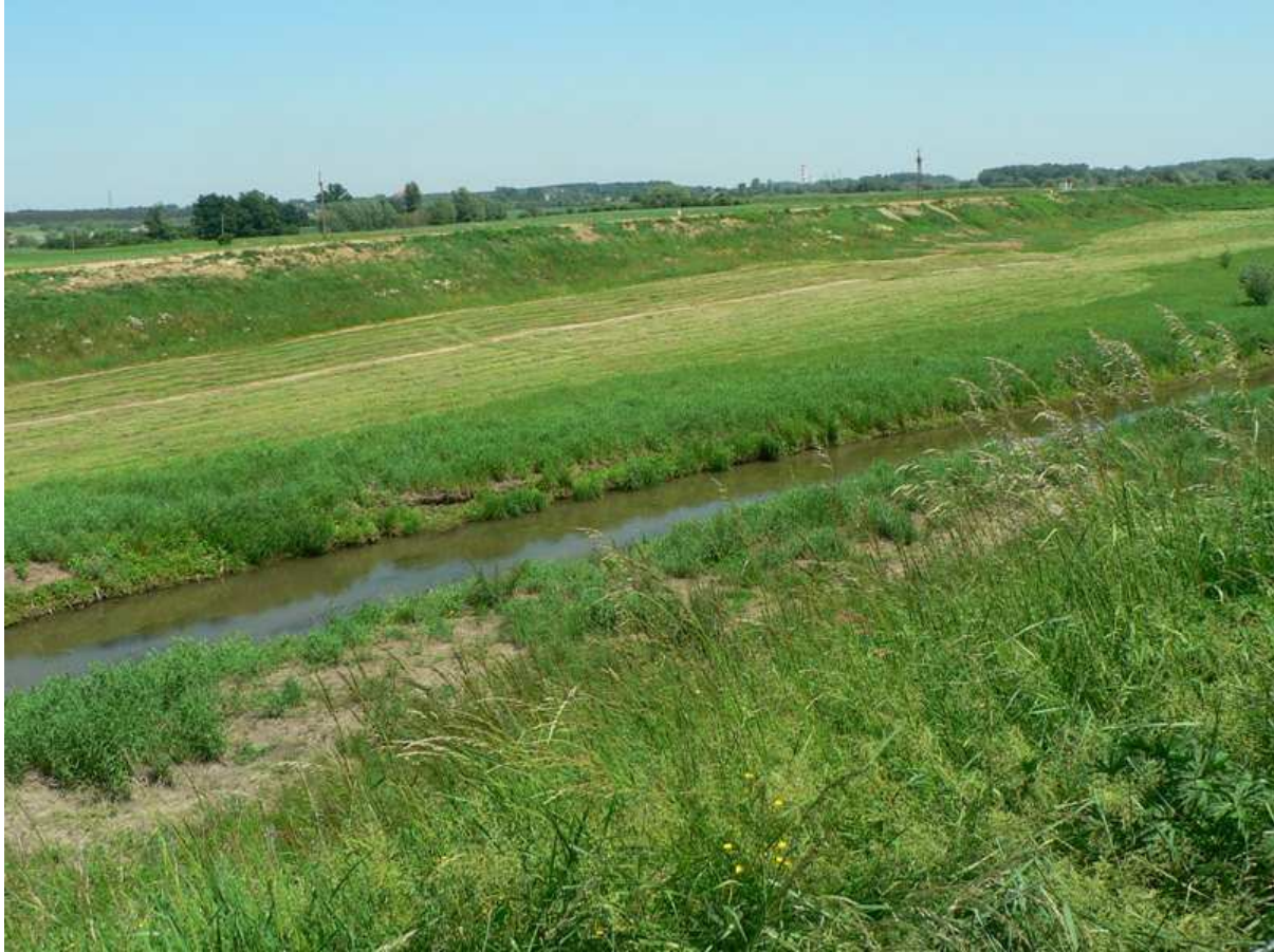
Rys. 3 Zabezpieczenia przeciwpowodziowego doliny Kanału Strumień w km 0+000 do km 12+980 zad.1 na terenie Gminy Łubnice i Połaniec pow. Staszów woj. Świętokrzyskie – porośnięte międzywale i skarpy
